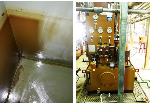
سیستم هیدرولیک توربین گازی ۷۹۴,۲ و رسوب وارنیش در مخزن روغن
