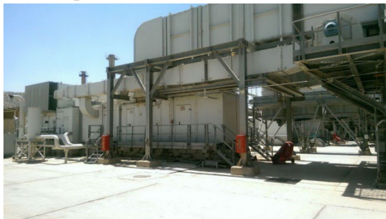
توربین گازی واحد 2 نیروگاه
